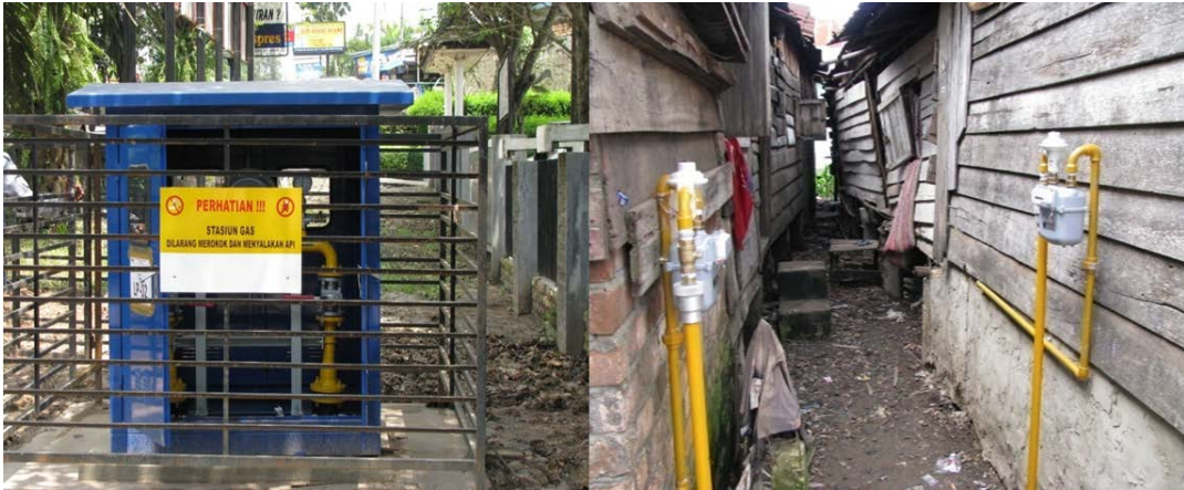
Gambar I-14 Instalasi Jaringan Gas Kota
