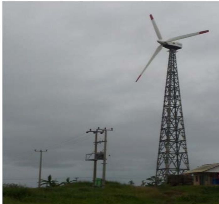
Gambar I-50 PLT Bayu 100 kW milik Puslitbang KEBTKE di Kec. Ciemas, Kab. Sukabumi
